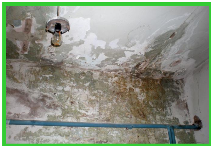
Аварийное состояние помещения школьной библиотеки
